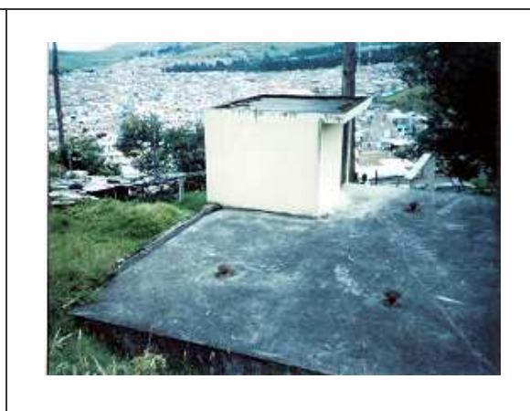
Figura 17. Tanque de abastecimiento de agua Barrio Arnulfo Guerrero.
