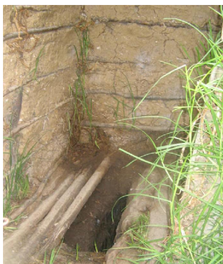
Figura 20. Parte interior de letrina en mal estado
