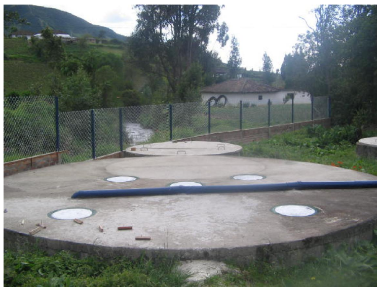
Figura 22. Colector final del alcantarillado
