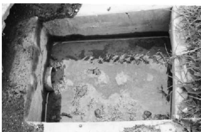
FOTOGRAFÍA N° 5. Caja de Inspección de la planta de tratamiento.
