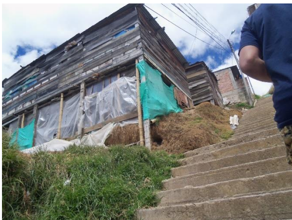
Ilustración 58 Viviendas en riesgo.
