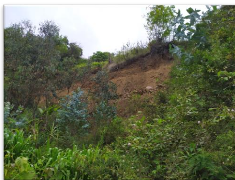
Figura 4. Cárcavas ocasionadas por deslizamientos en la Vereda Veracruz
