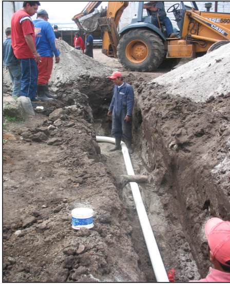
Figura 84.- Tubería y codo en PVC.
