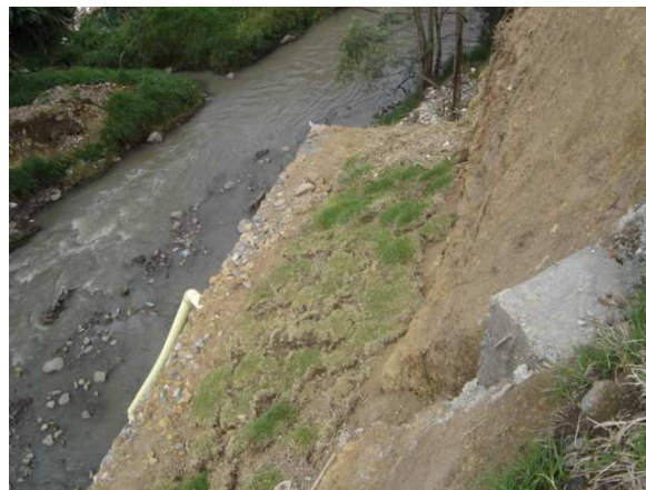
Fotografía No 171. Anclaje para tubería de seis pulgadas (6")
