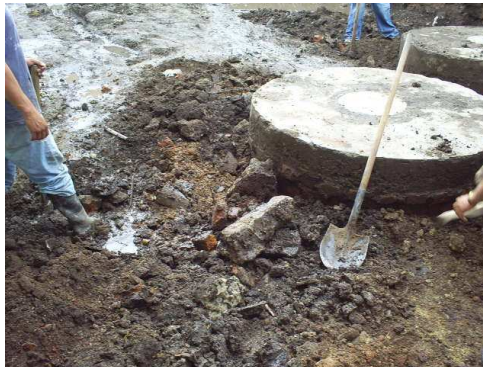
Fotografía No 11. Sobreexcavación por presencia de escombros
