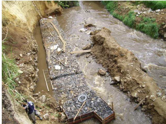
Fotografía No 142. Muro parcialmente inundado
