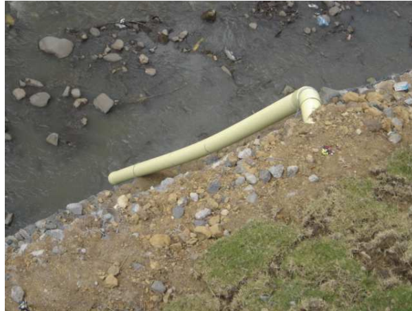
Fotografía No 170. Tubería Novafort de seis pulgadas (6")
