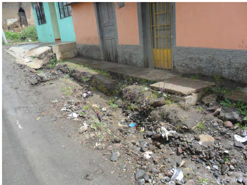
Fotografía 9. Estado de cuneta corregimiento de Jongovito.
