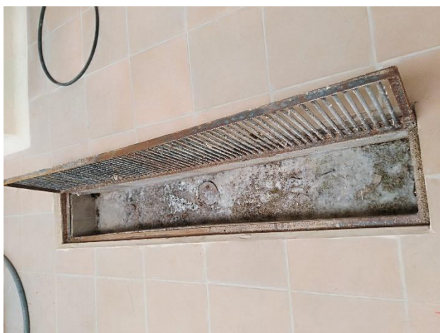
Figura 11. Rejillas de protección para los canales de desagüe
