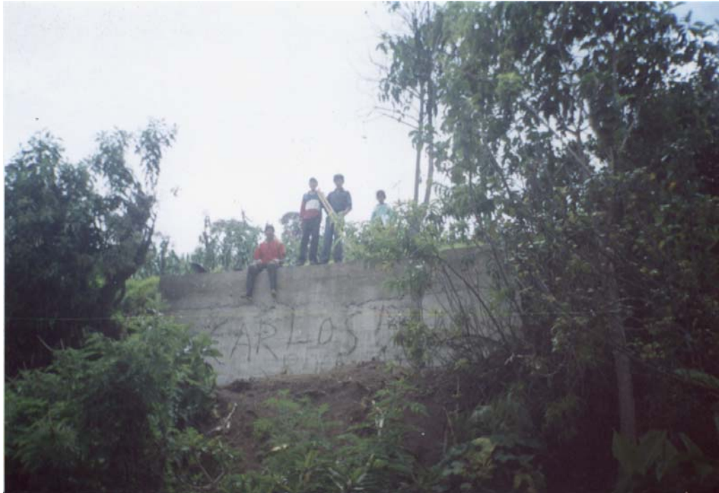
Figura 18. Muro de contención en la vereda San José de Córdoba.
