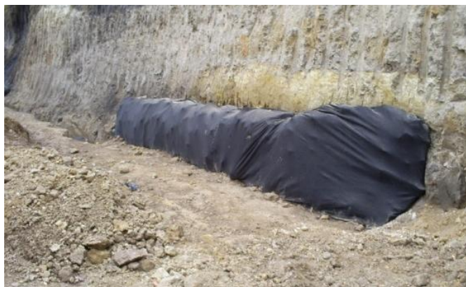
Figura 23. Filtro en talud
