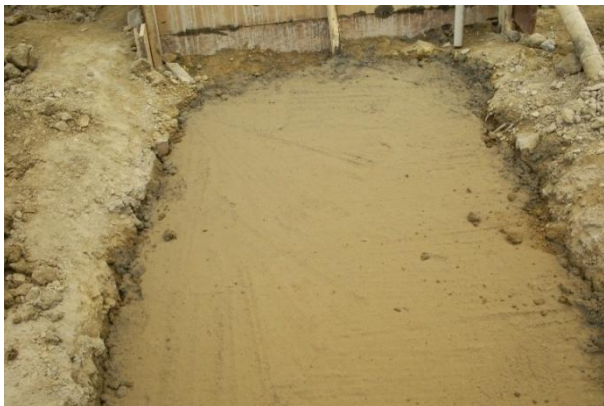
Punto de referencia K0+130, revestimiento por su quedar muy superficial
