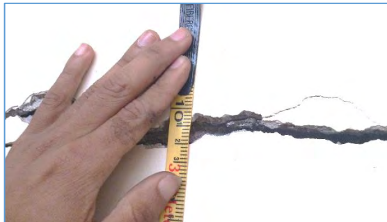
Figura 3. Muros de la edificación con fisuras
