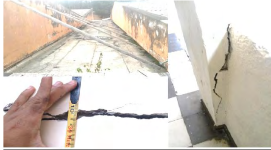
Figura 2. Muros de la fachada en mal estado
