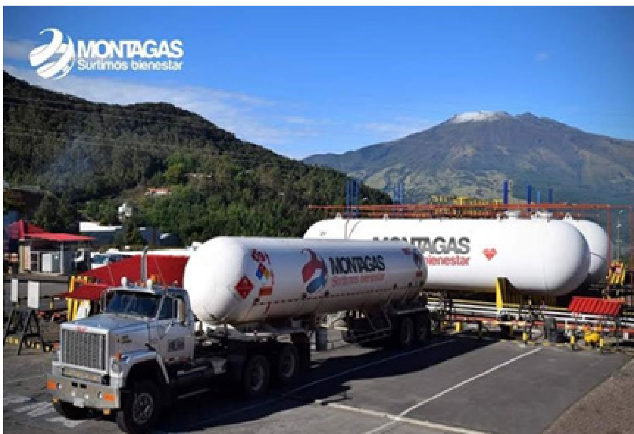
Figura 106. Instalaciones de almacenamiento Montagas
