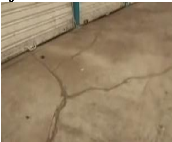
Figura 2. Pisos en mal estado
