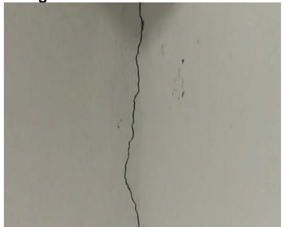
Figura 3. Paredes en mal estado
