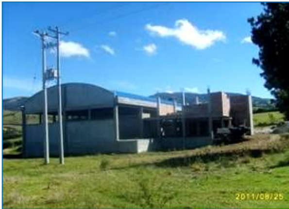
Fachada posterior – transformador de luz
