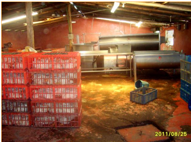
Sala de Proceso
