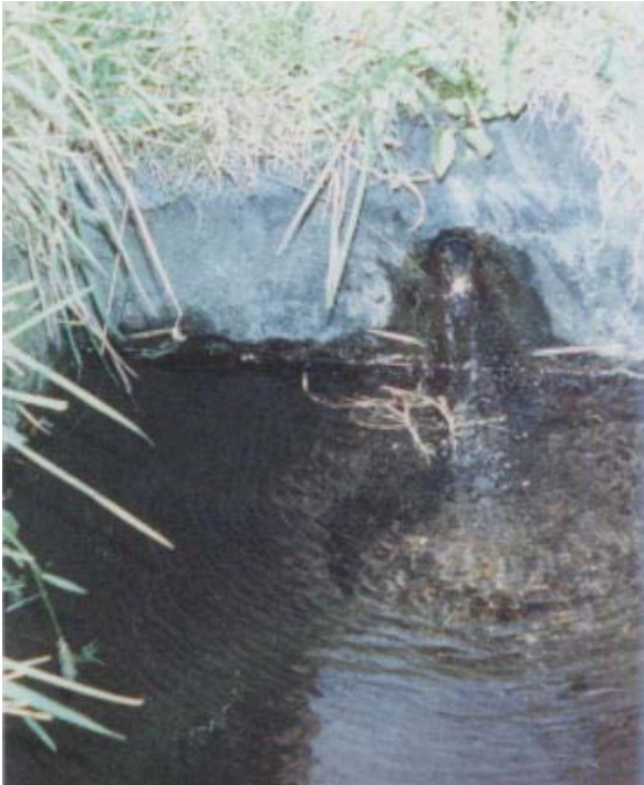
Foto 4. Desarenador del sistema de acueducto.
