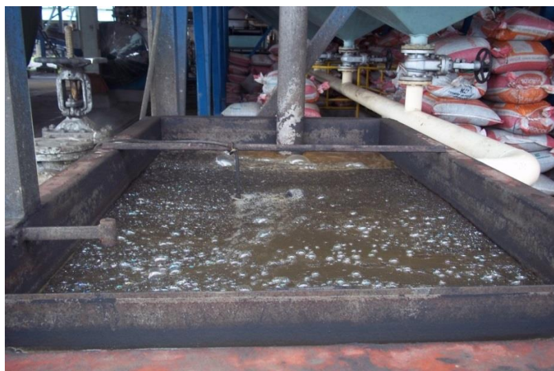
Tanque receptor salida de flujo de efluentes
