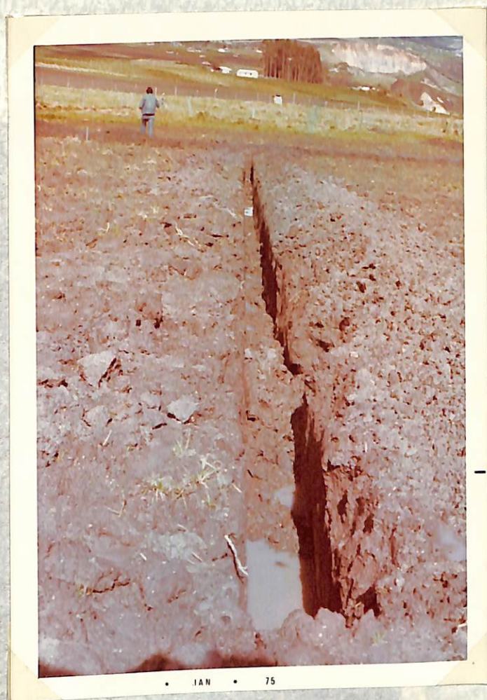
FIGURA 34. Erosión en los taludes de drenes internos abiertos
