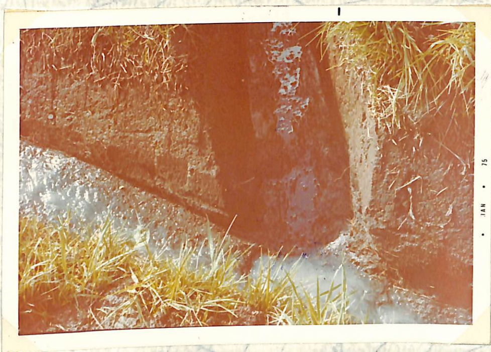
FIGURA 36. Empalme entre una zanja perimetral y un dren colector sin cubrir
