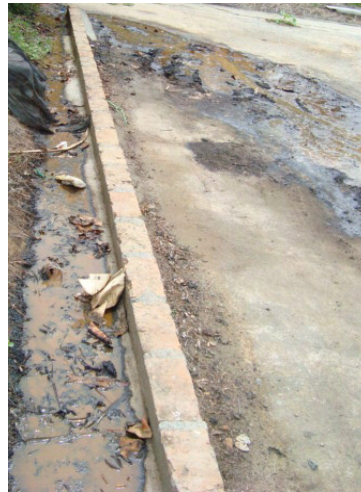
Figura 20. Afluentes de lixiviado.
