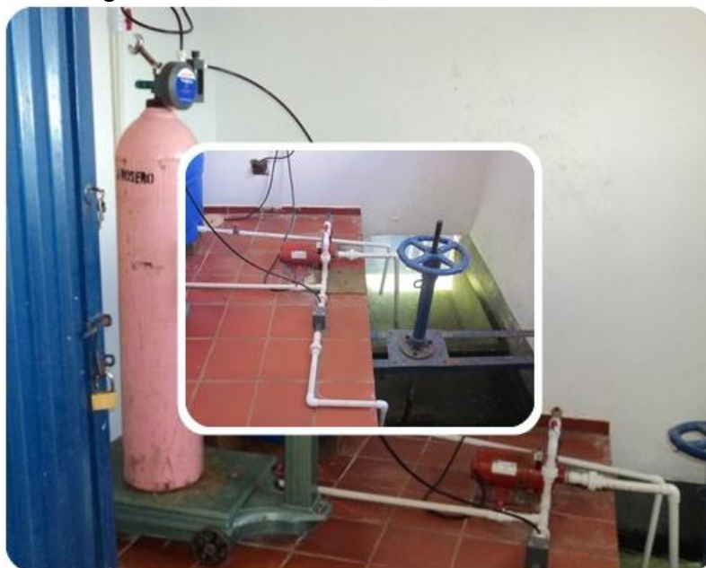
Figura 4. Sistema de bombeo – M. Los Andes
