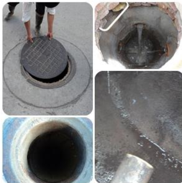
Figura 6. Cámaras de inspección – M. Los Andes
