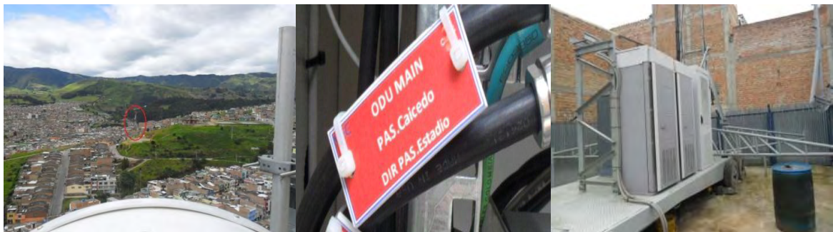
Figura 24. Fotografías de Línea de vista, marquilla y estación Caicedo.
