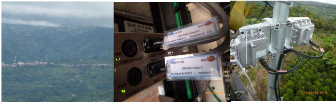
Figura 25. Fotografías de Línea de vista, conexión de energía y ODU'S instaladas en enlace La Unión Nariño
