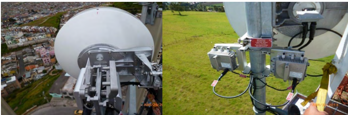
Figura17. ODUS instaladas derecha: con soporte y jumper, izquierda: con unión a HIBRIDO. Fuente: propia de este trabajo
