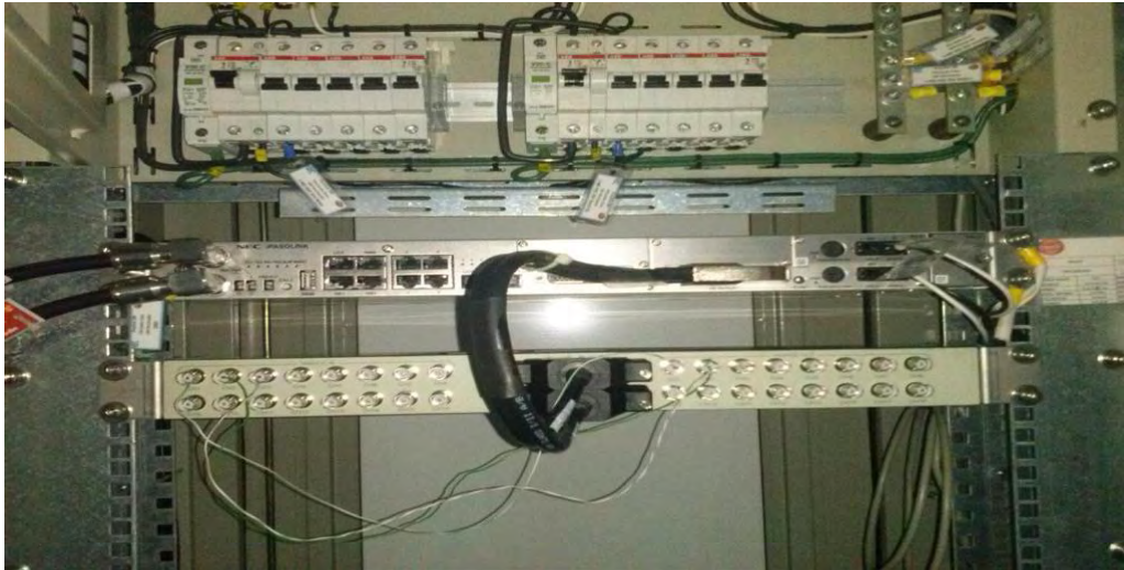
Figura2. IDU instalada y maquillada. Fuente: propia de este trabajo
