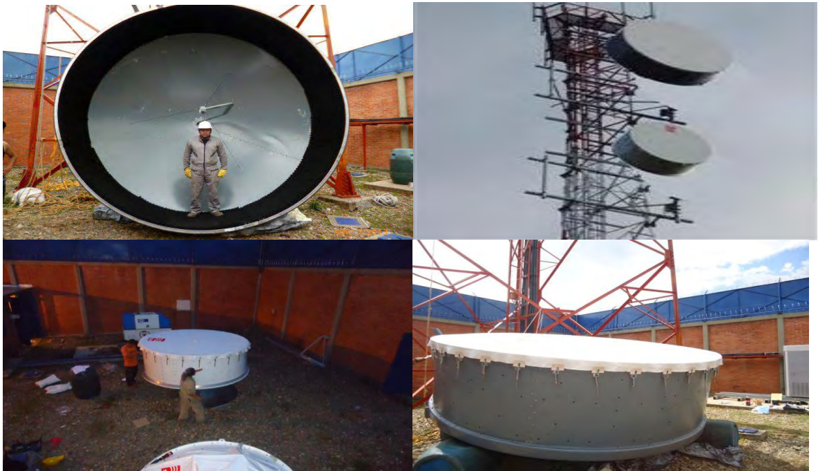
Figura 28. Fotografías instalación, superior: tamaño antenna, antenas instaladas, Inferior: antenas en etapa de instalación.
