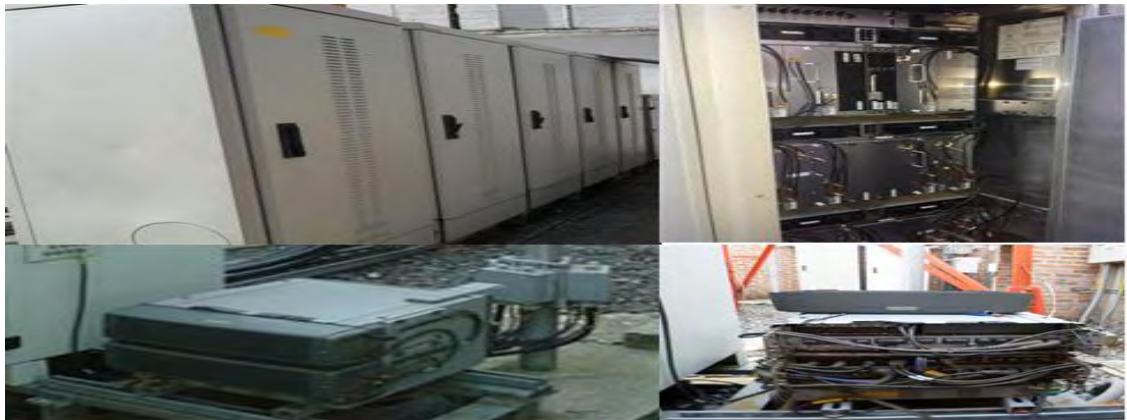
Figura 3. Fotografías equipos de telefonía móvil, superior: BTS segunda generación; inferior: NODO B tercera generación.
