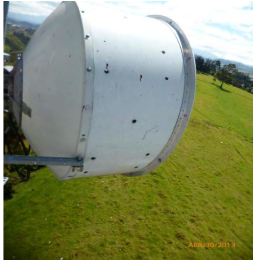
Figura11. Antena instalada de 1.2 metros. Fuente: propia de este trabajo
