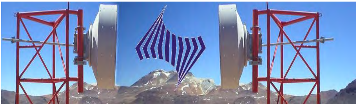
Figura 6. Antenas de radioenlace
