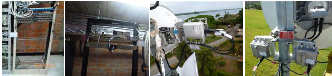
Figura 12. Fotografía. De izquierda a derecha: espacio rack, IDU instalada, ODU sin guía de onda, ODU con guía de onda.
