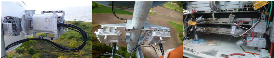
Figura 7. Fotografía de las Partes de un radio NEC instaladas. Derecha: IDU, centro: ODU'S, izquierda: ODUS e HIBRIDO
