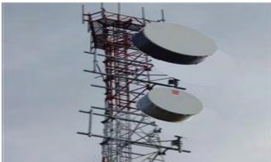
Figura 8. Fotografía Antenas con diversidad de espacio
