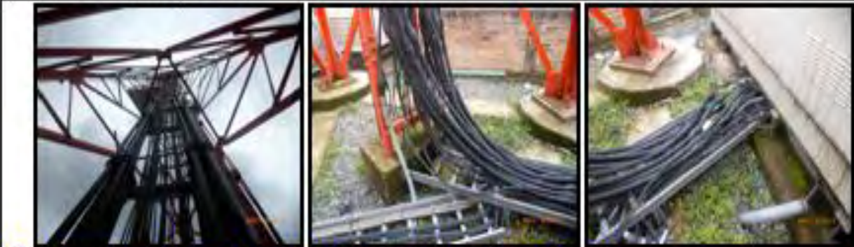
* Fotos de toma de tierra en la torre (platinar a burbar) indicando su altura y parición de libras. N/A.
