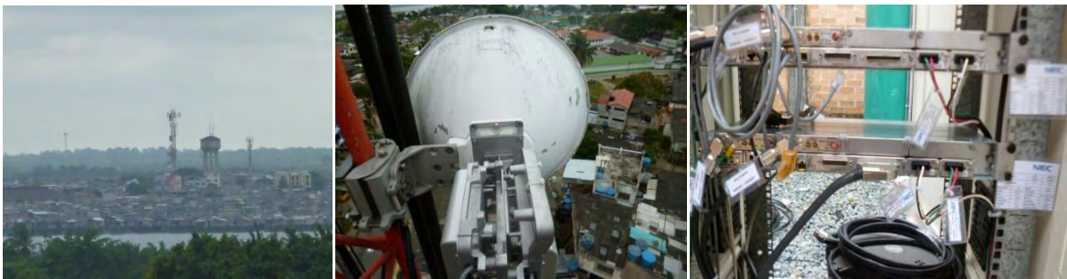
Figura 19. Fotografía Instalaciones Tumaco.
