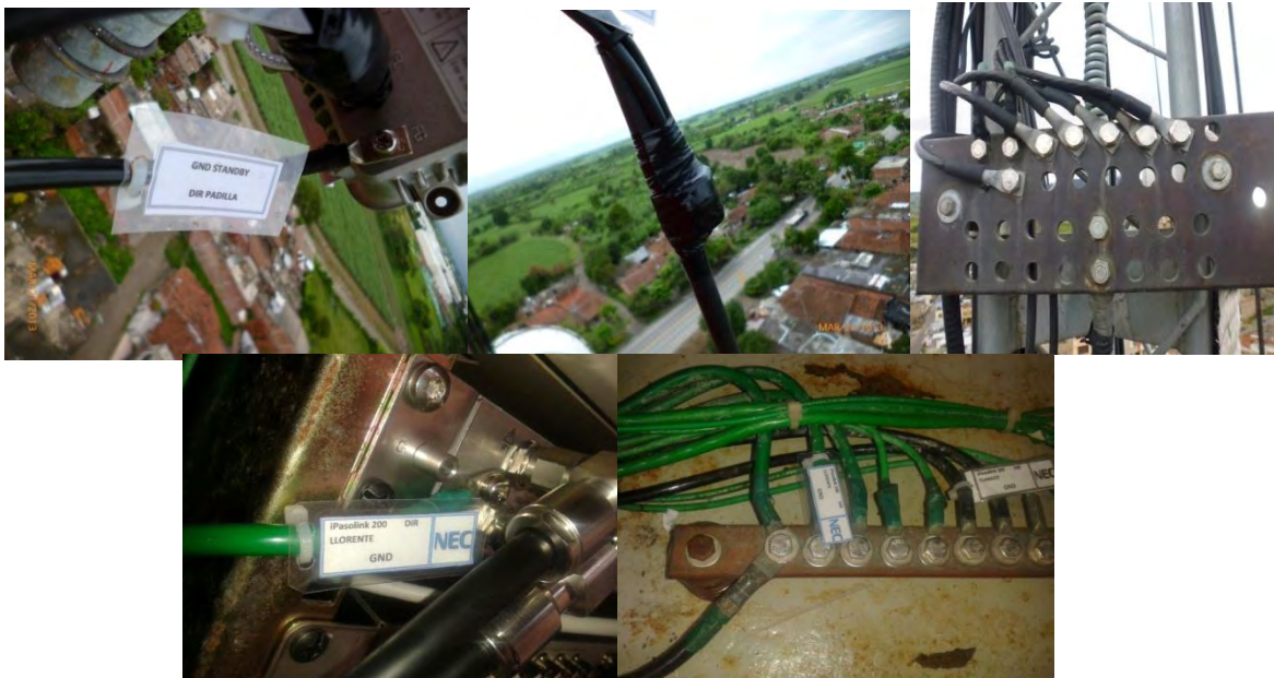
Figura24. Puestas a tierra, superior conexión ODU en bajante y barraje, inferior conexión IDU. Fuente: propia de este trabajo
