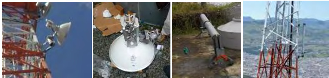
Figura 11. Fotografías antenas y soportes Derecha: antenas instalada y antes de instalar, izquierda: mástil sin instalar e instalado.
