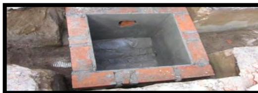
Imagen 117. Caja de inspección 0.8x0.8m.
