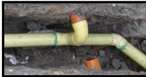
Imagen 119. Tubería ventilación" PVC.
