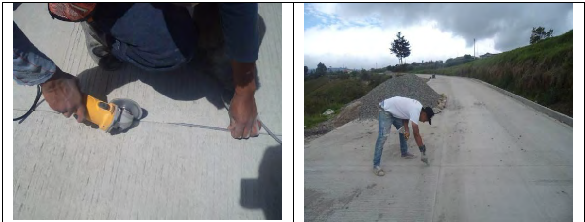
Fig. Nº 33 Sellado de juntas, (imagen a indica producto para el sellado de juntas, imagen b indica rectificación de juntas con pulidora manual, para posterior limpieza).
