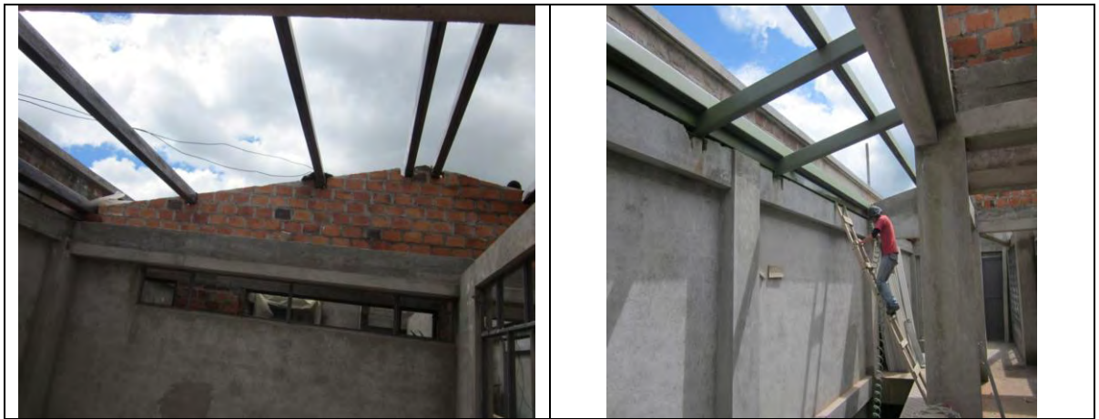
Fig. N° 2 Piso del auditorio, (imagen a: indica el piso del auditorio repollado y nivelado, imagen b: indica instalación de piso en cerámica).
