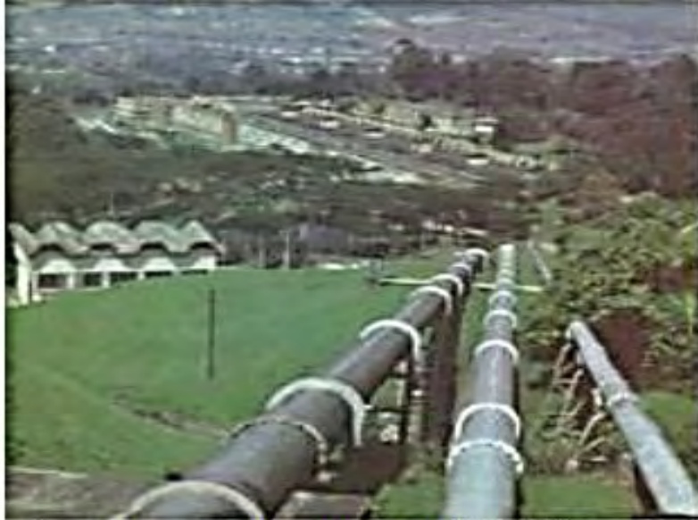
Imagen 16: Tubería central hidroeléctrica Ayura
