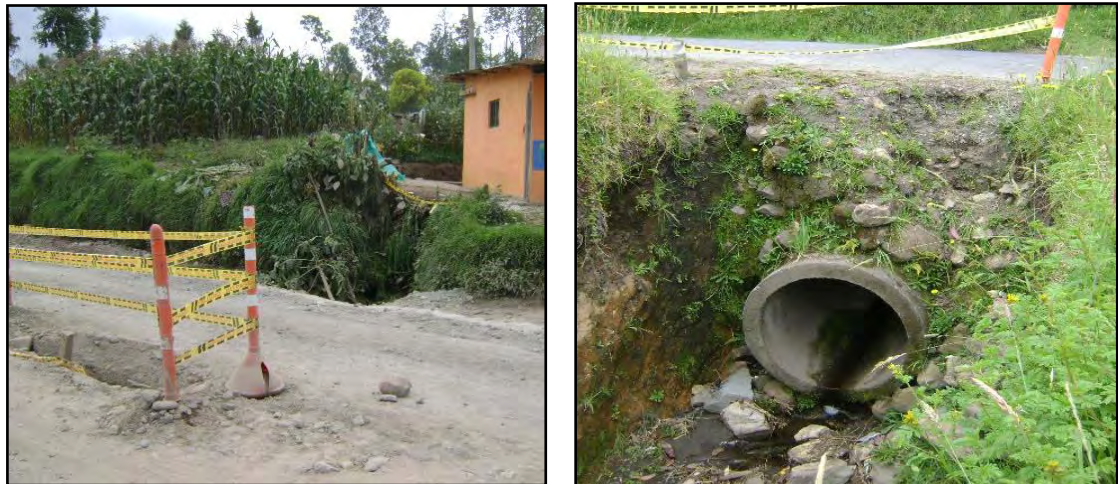
Figura 4. Alcantarillas existentes. Izq. Alcantarilla K104+ 430 sin unidad de entrada. Der. Alcantarilla K100+ 010 sin unidad de salida.
