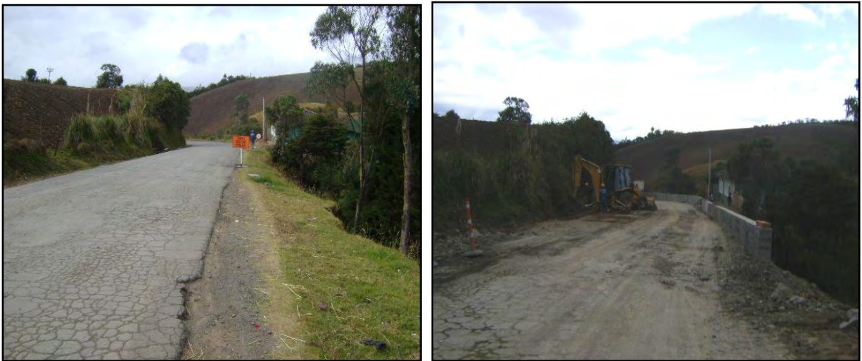
Figura 3. Muro en concreto reforzado K101+410 – K101+450 margen derecho. Registro fotográfico antes y después de la construcción del muro.
