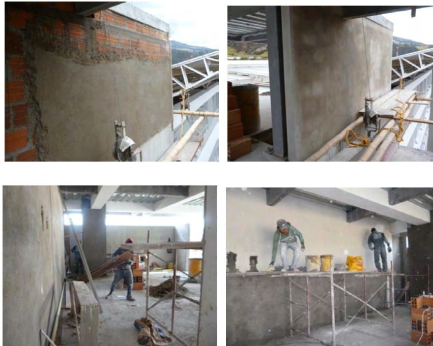
Figura 50. Estuco sobre muro en mampostería.
