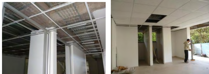
Figura 52. Cielo raso en fibra mineral.
