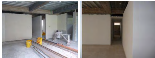
Figura 19. Estuco en zona de oficinas.
