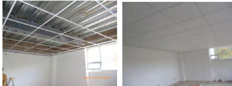
Figura 26. Cielo raso en fibra mineral.
