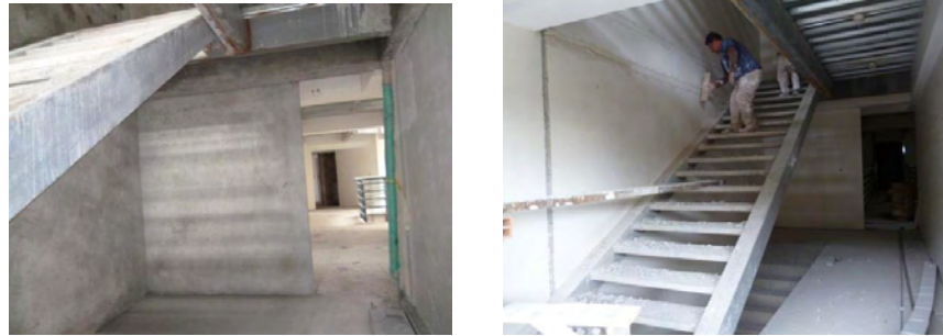
Figura 18. Estuco en zona de escaleras.
