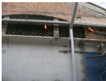
Figura 99. Canal aguas lluvias calibre 20.
