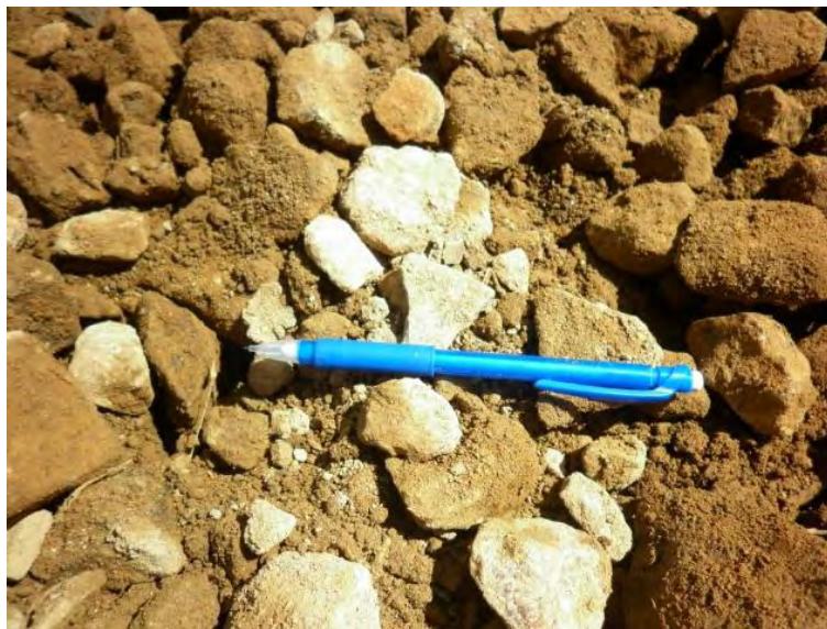
Figura N° 38 – Material filtrante – Presencia significativa de material fino, no apto para la construcción de subdrenes
