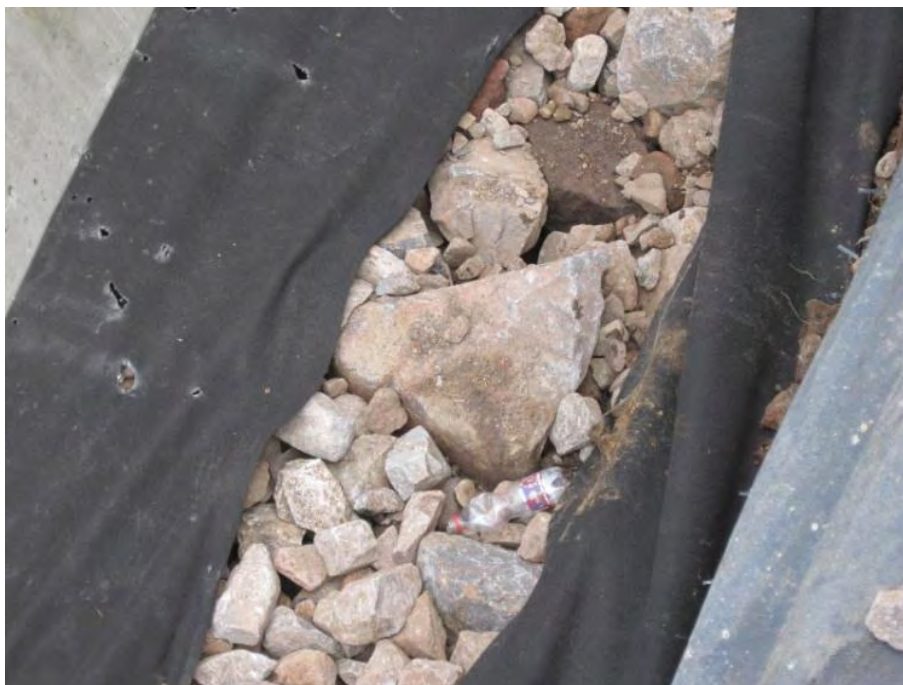
Figura N° 36 – Material filtrante – Material granular con tamaño superior a 3” y contaminación con material plástico
