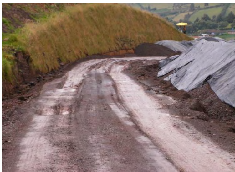
Figura N° 21 – Base granular dañada – Capa de base granular afectada por la lluvia y vehículos de transporte de material.
