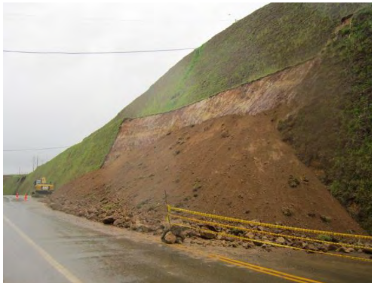
Figura N° 12 – Derrumbe de talud – Deslizamiento de talud en margen derecho de vía. Correcta señalización y utilización de equipos de remoción
