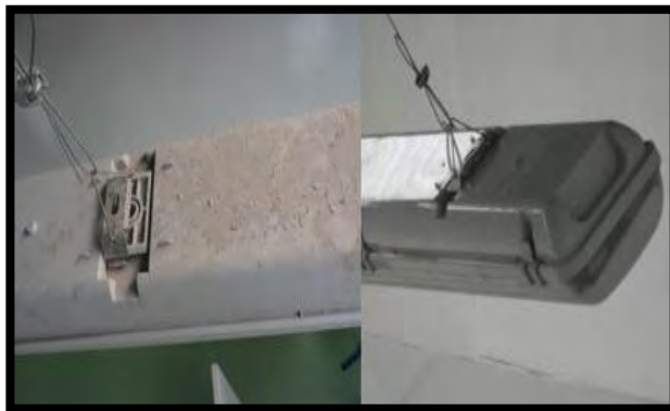
Imagen 9. Lámparas y sistemas de cableado eléctrico
