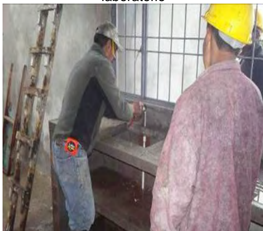
Imagen 111. Punto hidráulico de ½” en laboratorio
