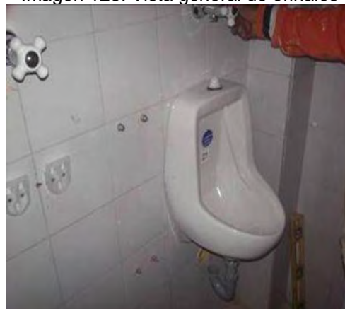
Imagen 128. Vista general de orinales
