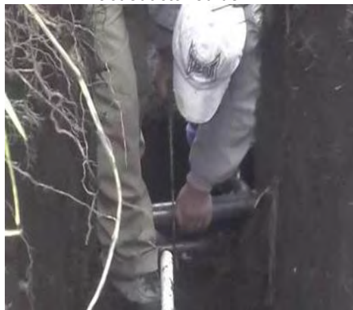
Imagen 109. Empalme con la red principal del acueducto red de 1”
