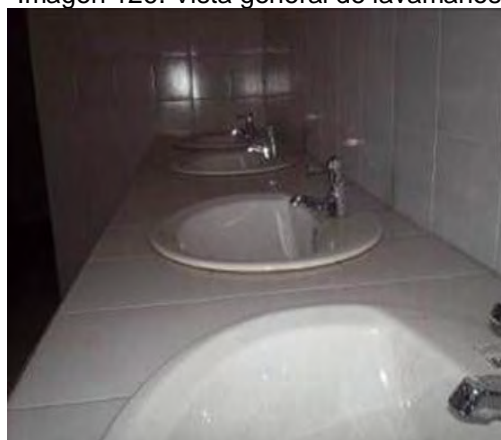
Imagen 126. Vista general de lavamanos
