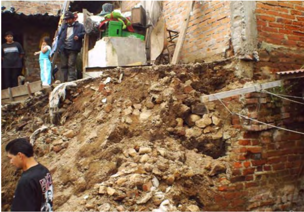
Figura 11. Colapso estructural, vivienda Cementerio - Camino Viejo
