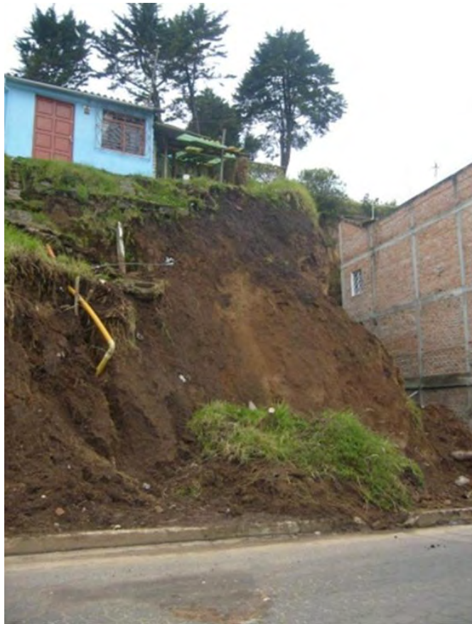
Figura 4. Ejemplo Deslizamiento, Barrio Alameda, año 2011.
