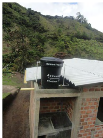
Imagen N° 36: Tanque de almacenamiento
