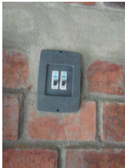
IMAGEN N° 40: CAJA DE DISTRIBUCION
