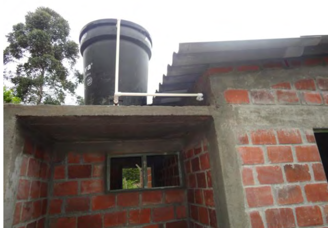
Imagen N° 37: Tanque de almacenamiento instalado
