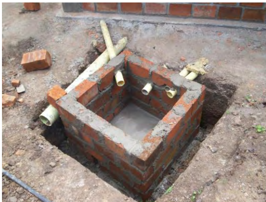
Imagen N° 38: Caja de inspección
