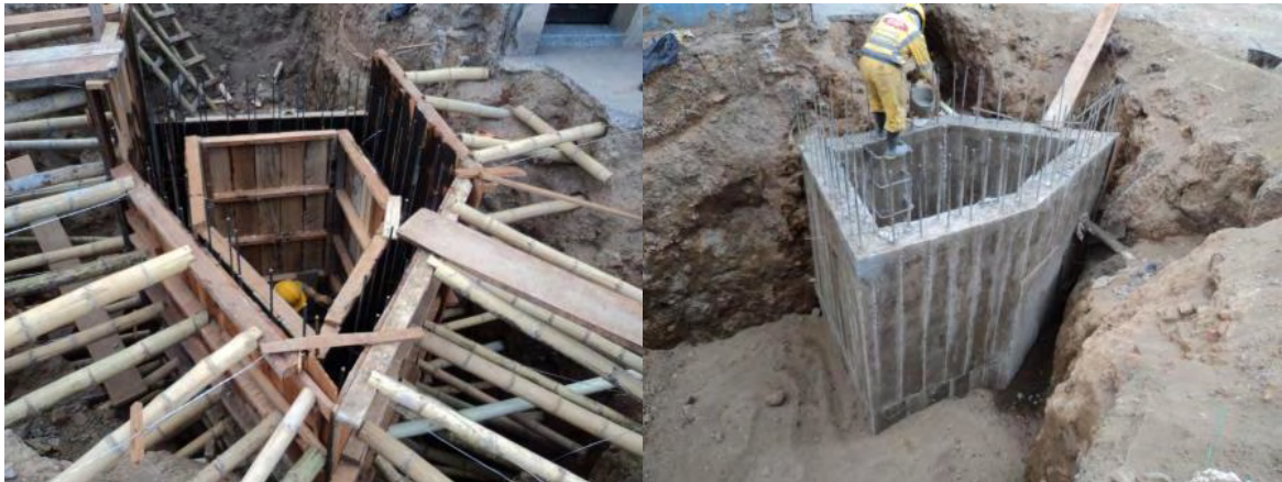
Figura 13, Cámara de inspección 15CS del Colector principal sanitario.
