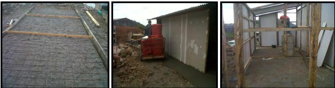
Ilustración 6. Placa de piso, divisiones y cubierta en zinc residuos biológicos.
