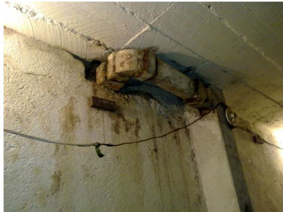
Figura 4. Instalaciones eléctricas y de gas sótano del bloque 1.
