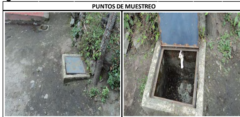
Figura 7. Punto de toma de muestras red de Distribución
