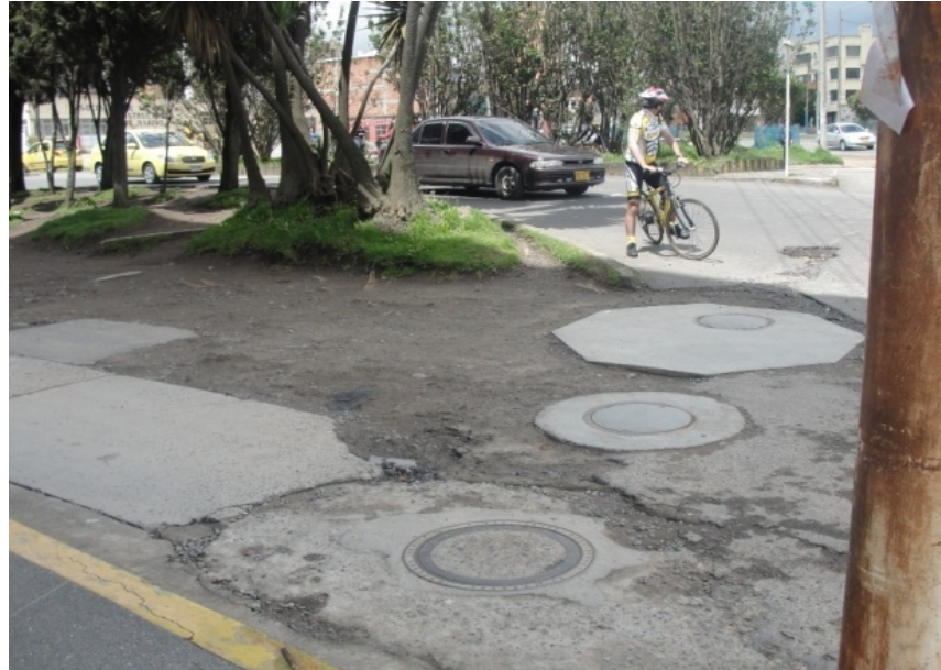
Figura 9. Fotografía detalle separadores deteriorados sector glorieta las banderas
