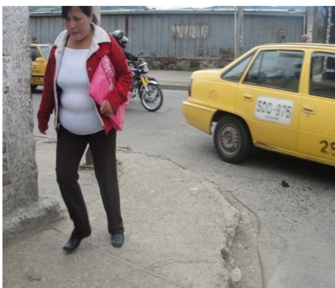
Figura 32. Fotografía detalle andenes en mal estado sector calle 16 – carrera9
