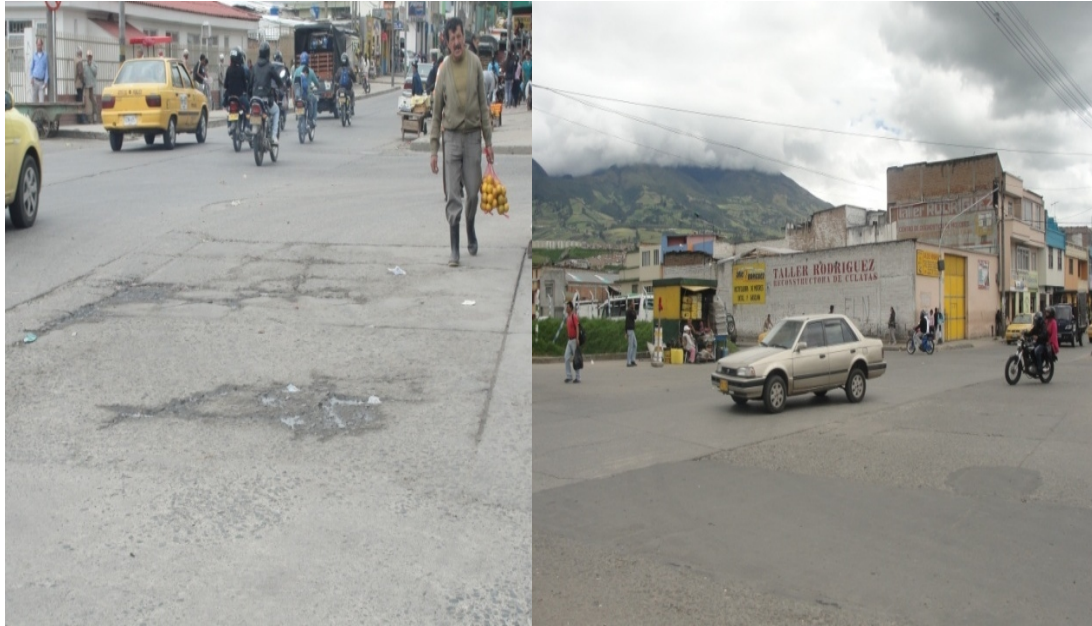
Figura 30. Fotografía detalle deterioro del pavimento cruce carrera 9 con calle 16
