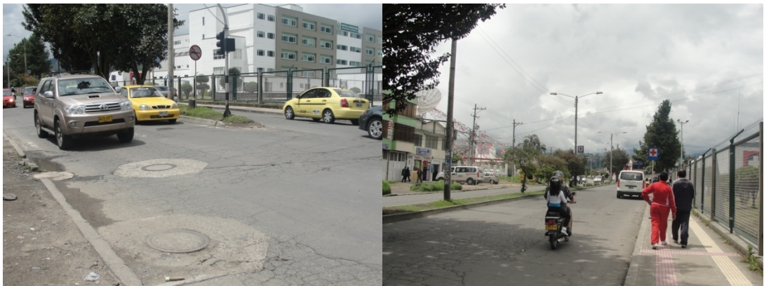
Figura 34. Fotografía detalle pavimento en mal estado sector calle 22 entre carrera 9 y 10
