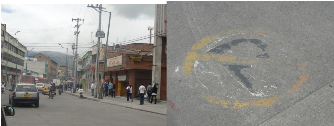
Figura 17. Fotografía detalle de pavimento – demarcación deficiente sector calle 17 entre carreras 19 y 20
