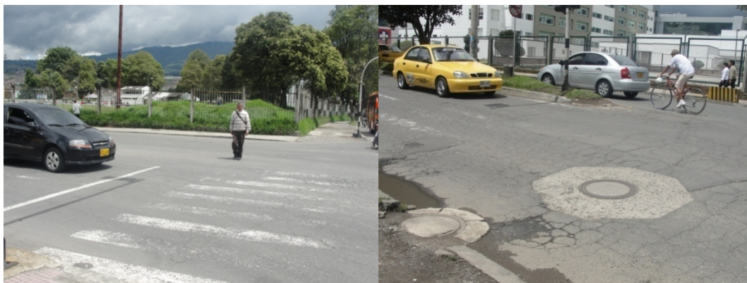
Figura 38. Fotografía detalle demarcación deficiente sector calle 22 con carrera 9 y 10
