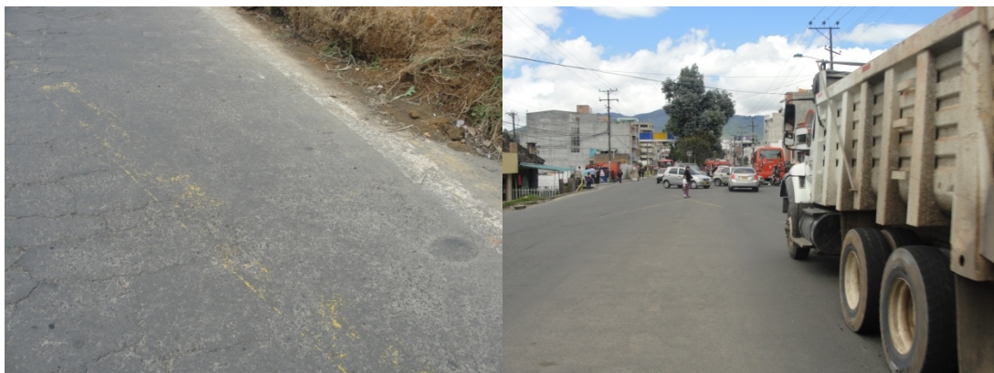
Figura 27. Fotografía detalle pavimento sin demarcación sector calle 18
