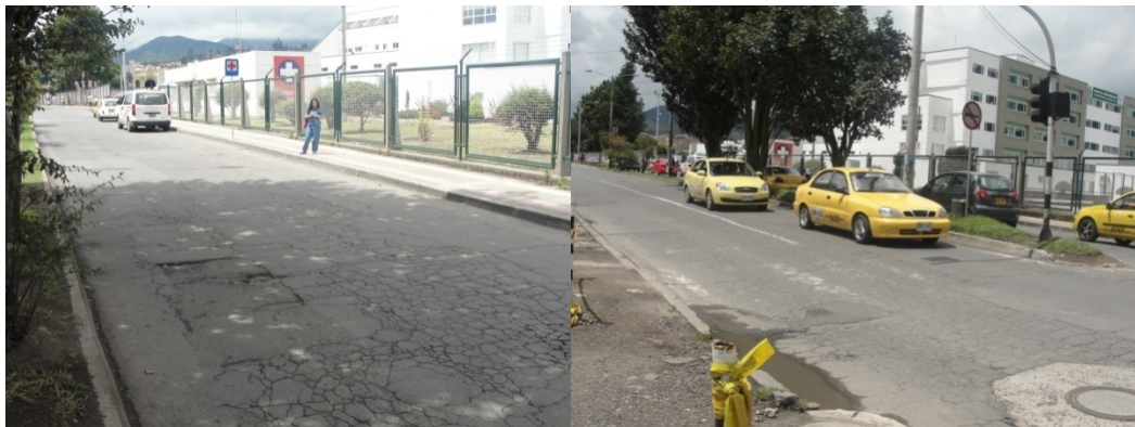
Figura 35. Fotografía detalle pavimento en mal estado demarcación deficiente sector calle 22 – carrera 9 y 10
