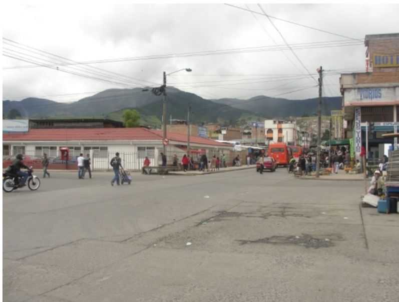
Figura 33. Fotografía detalle pavimento sin demarcación sector calle 16–carrera 9
