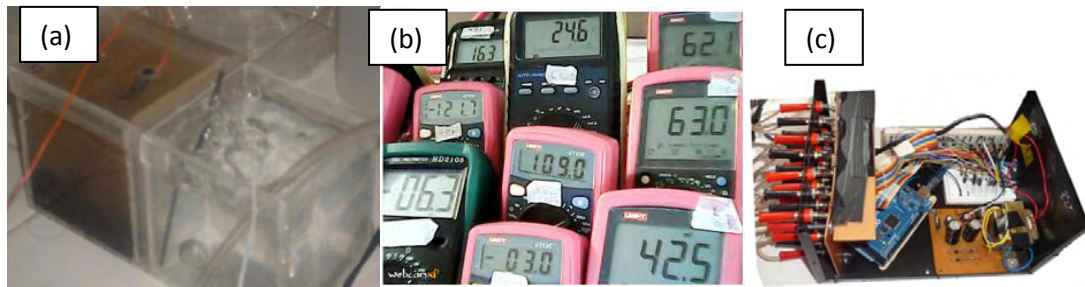
Figura 5. (a) Operación de CCM, (b) Monitoreo de CCMs Registro de voltaje multímetros fluker, (c) Registro voltaje sistema SAD
