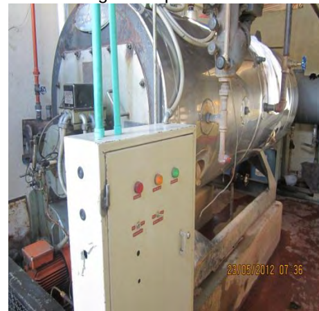
Zona de calderas
