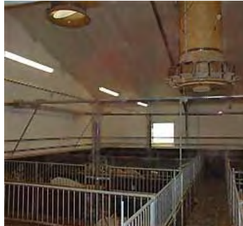
Figura 12. Sistema de ventilación por presión neutra
