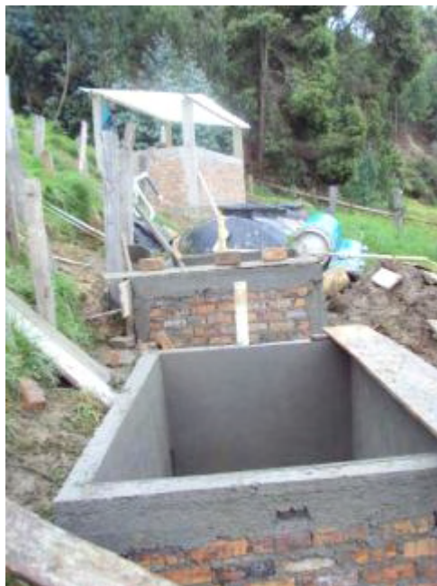
Figura #42. Montaje sistema tratamiento Aguas residuales
