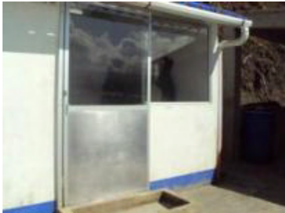
Figura # 3. Entrada planta de proceso
