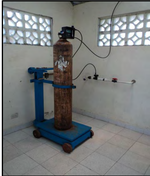
Figura 3. Sistema de cloración– municipio de Túquerres
