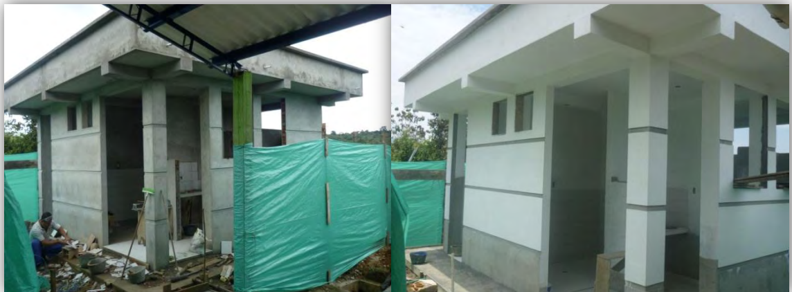
Figura 72. Bateria sanitaria sede-Alemania
