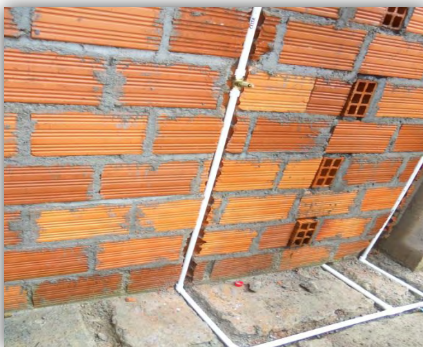
Figura 46. Conduccion de agua potable
