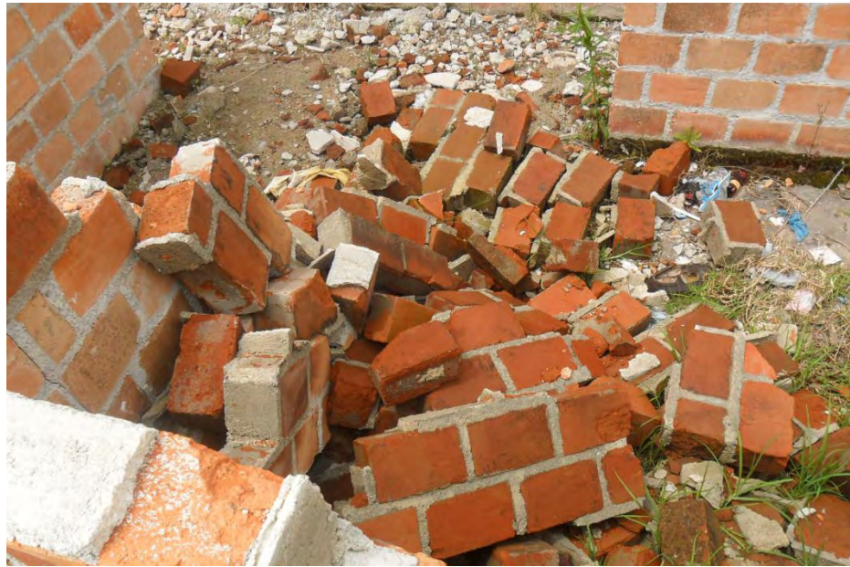
FIGURA No. 14. DESTRUCCIÓN MUROS DIVISORIOS CAUSADO POR LA UTILIZACIÓN DE MATERIALES DE PESIMA CALIDAD.
