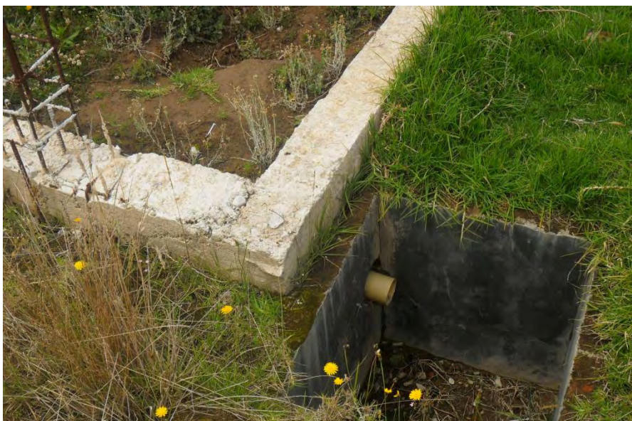
CAJILLA DE INSPECCIÓN.
