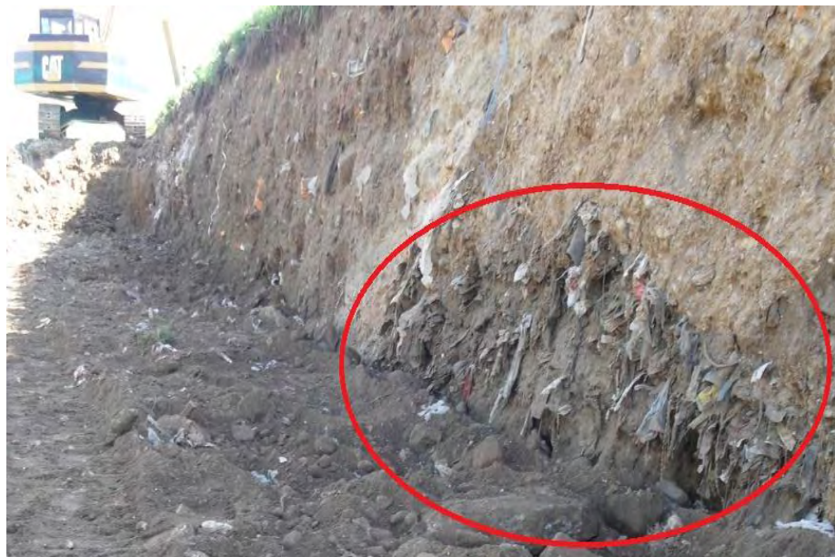
FIGURA No. 21. AVANCE DE CAJEO A PARTIR DEL K0+650 – DETECCIÓN DE BASURA ACUMULADA A NIVEL DE LA SUBRASANTE E INCLUSIVE A MÁS DE 3 METROS DE PROFUNDIDAD DE LA COTA TERRENO
