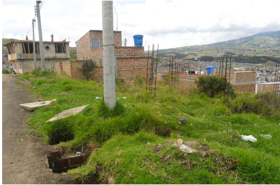
OBRAS HIDROSANITARIAS DETERIORADAS Y ABANDONADAS.
