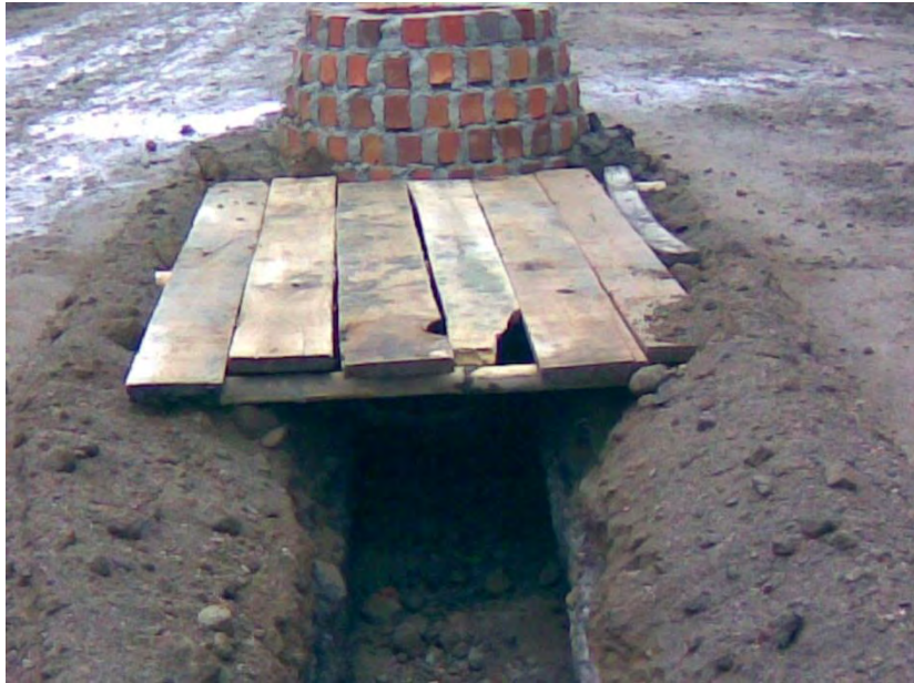
VERIFICACIÓN DEL CUMPLIMIENTO DE MEDIDAS DE SEGURIDAD Y CONTROL CAMARA DE INSPECCION
