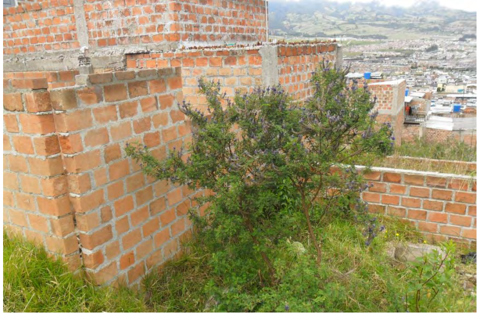
VEGETACIÓN EXISTENTE POR CAUSA DE ABANDONO DE LA CONSTRUCCIÓN.
