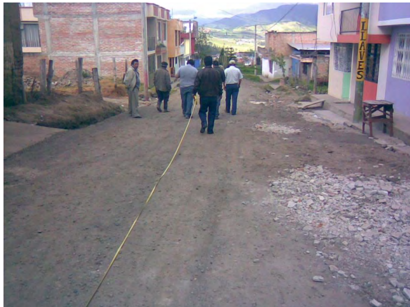
FIGURA No. 8. VERIFICACION DE LONGITUD PARCIAL. CONSTRUCCIÓN DE ALCANTARILLADO DE AGUAS NEGRAS VEREDA SAN MARTIN CORREGIMIENTO DE CATAMBUCO
