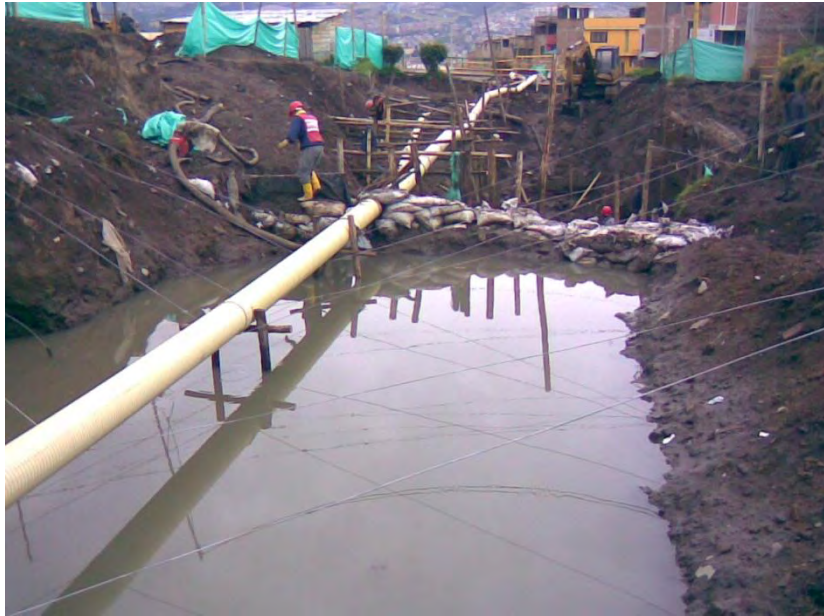
FIGURA No.18. ACUMULACION DE AGUAS RESIDUALES PROVENIENTES DE LOS BARRIOS PERIFÉRICOS A ESTE SECTOR.
