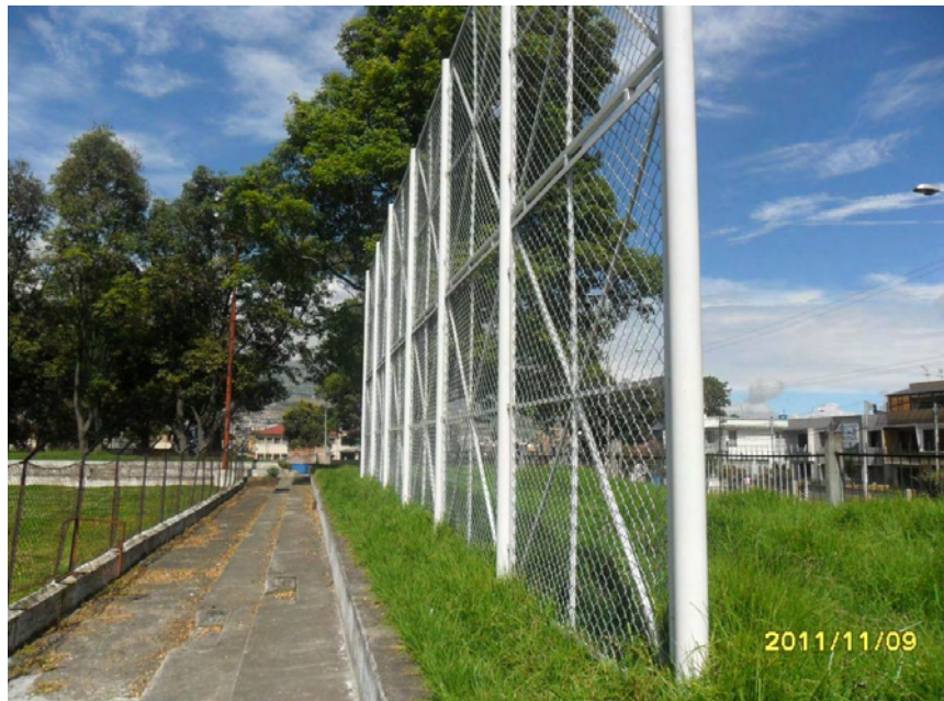
FIGURA No. 29. VISTA LATERAL DEL CERRAMIENTO CANCHA DE FUTBOL PARQUE BOLÍVAR MUNICIPIO DE PASTO
