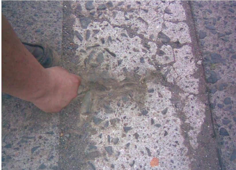
FIGURA No. 9 AGRIETAMIENTO CONCRETO DE 3000 PSI. ALCANTARILLADO DE AGUAS NEGRAS SECTOR DE SAN MARTIN CORREGIMIENTO DE CATAMBUCO
