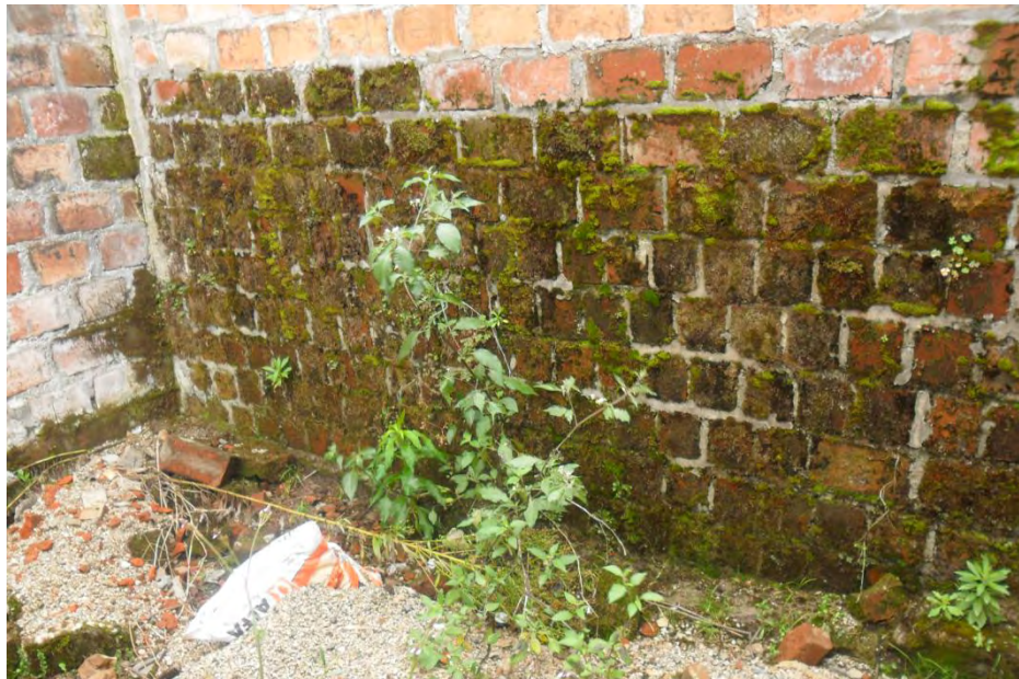
HUMEDAD PRODUCIDA POR FALTA DE OBRAS DE FILTRACIÓN.
