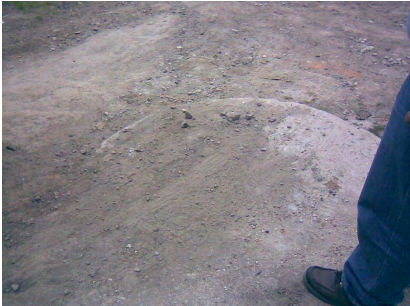
FIGURA No. 5. CAMARA DE ARRANQUE ALCANTARILLADO DE AGUAS NEGRAS SECTOR DE TESCUAL BAJO CORREGIMIENTO DE MORASURCO.
