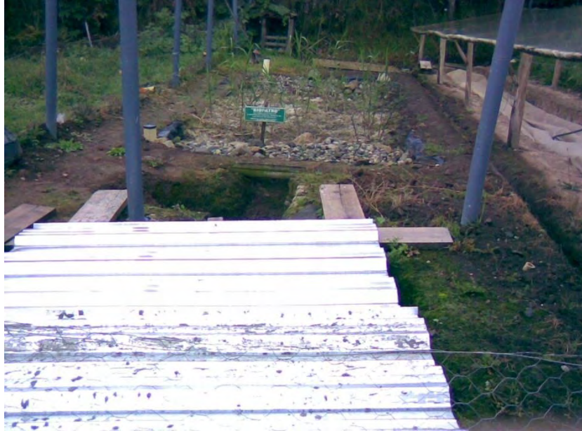
BIOFILTRO VISTA FRONTAL.
