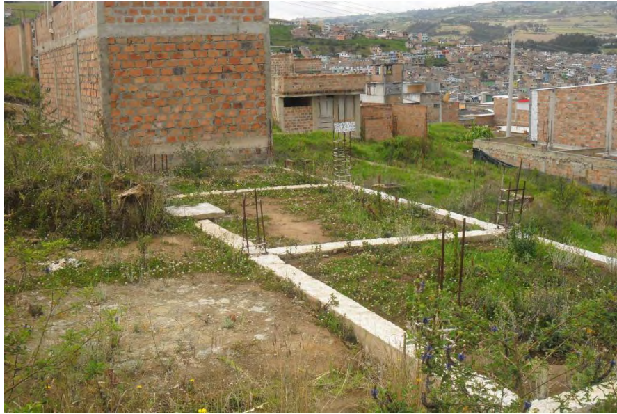
FIGURA No. 13. CIMENTACIÓN DE LA VIVIENDA ABANDONADA POR NEGLIGENCIA DEL CONTRATISTA.
