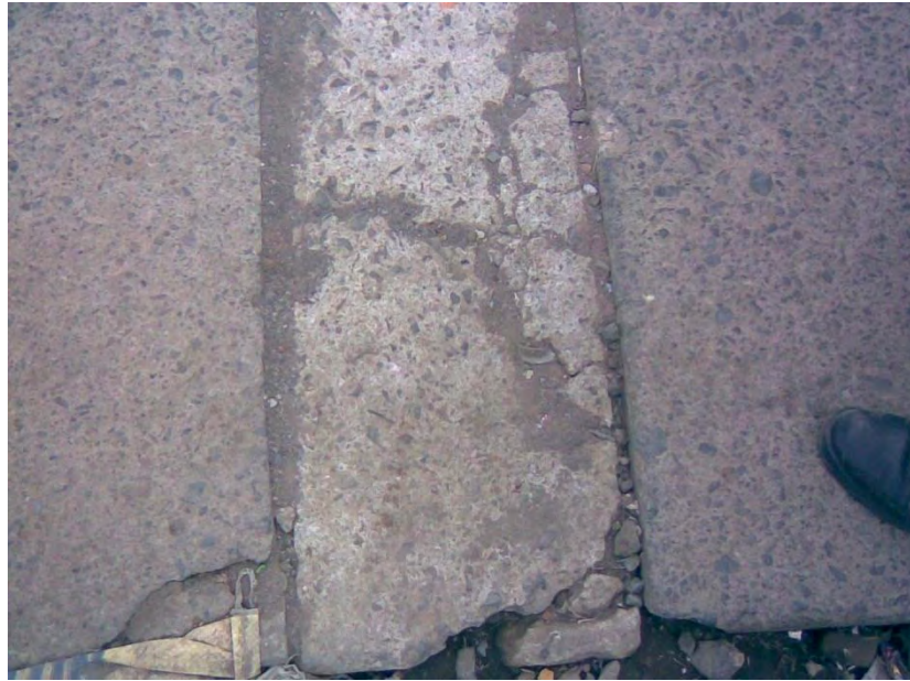
FISURAMIENTO JUNTAS DE DILATACION.
