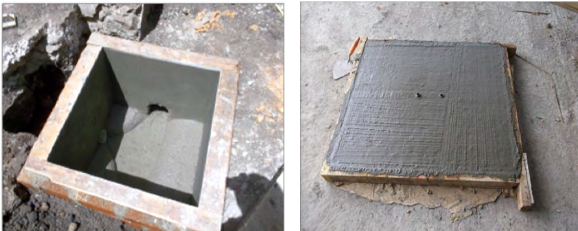
Imagen 37. Caja de inspección.
