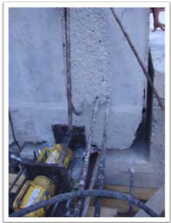
Figura 57: Movimiento horizontal de la viga
