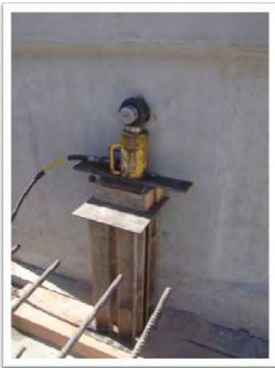
Figura 56: Movimiento vertical de la viga
