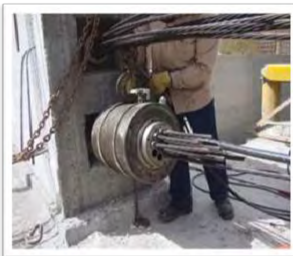
Figura 59: Ubicación de equipo de tensionamiento
