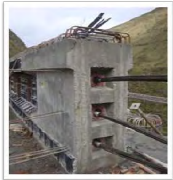
Figura 42: Anclaje activo antes de tensionar.
