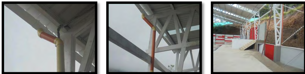
Figura 37. Bajante de aguas lluvias - CIC.
