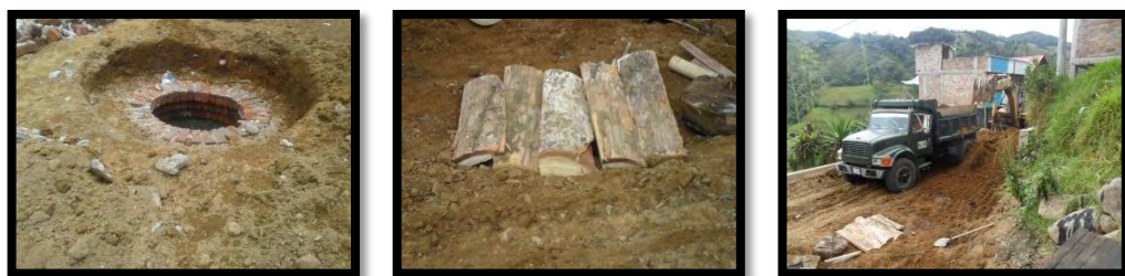
Figura 61. Protección de las cámaras de inspección.
