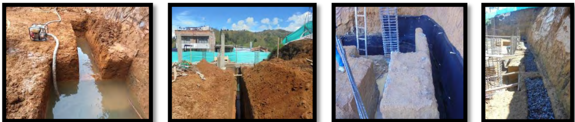
Figura 9. Filtro construido en el CIC.
