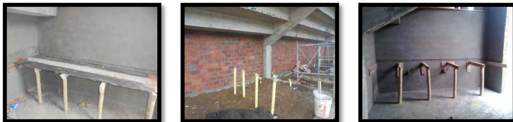
Figura 35. Puntos hidráulicos de 1/2", 1/4" Y 1" PVC.
