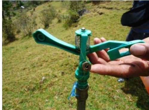
Figura 3. Aspersor de diferente referencia al entregado y en mal estado.
