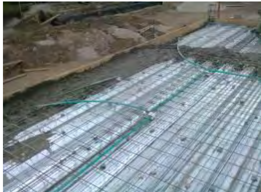
Figura 20. Detalle malla e instalaciones eléctricas
