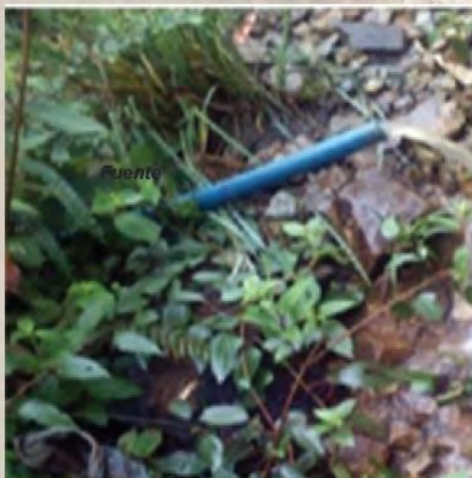
Foto 18: Inadecuada disposición de aguas mina El Páramo. foto: Arturo Yela - Esta investigación.
