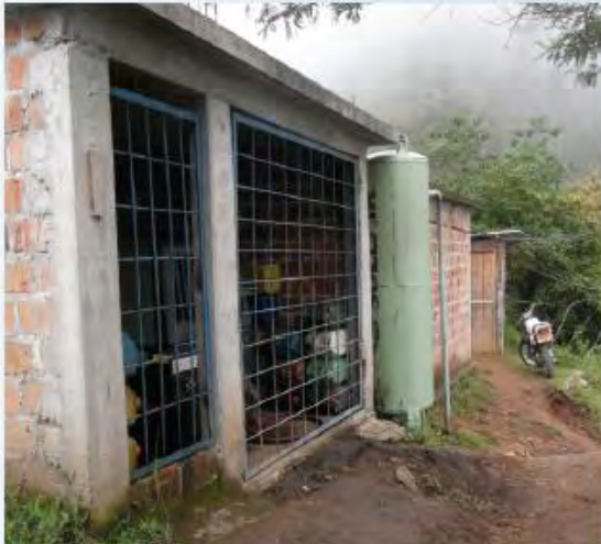
Foto 43: Ventilación compresor mina La Palmera Foto: Arturo Yela - Esta investigación.
