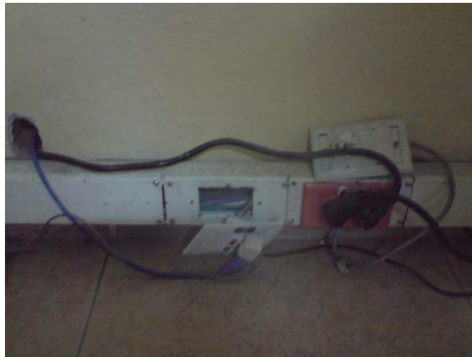
Figura 6.28. Toma de datos en mal estado y hueco en la pared.
