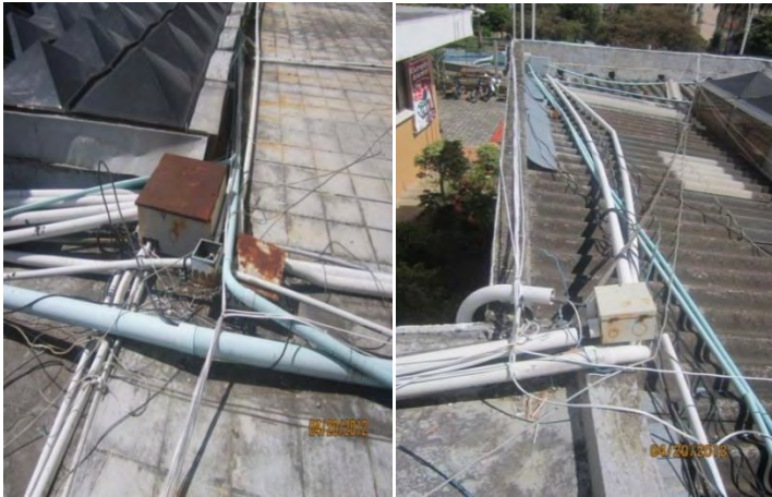
Figura 6.11. Acometidas en terraza del primer piso
