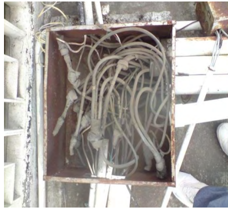
Figura 6.2. Caja de paso en terraza.
