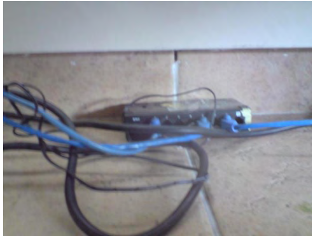
Figura 6.30. Switch mal instalado.
