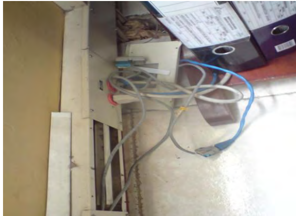
Figura 6.36. Toma salido de la canaleta.
