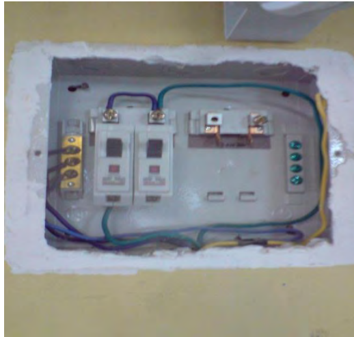
Figura 6.9. Tablero de distribución en quejas y reclamos.
