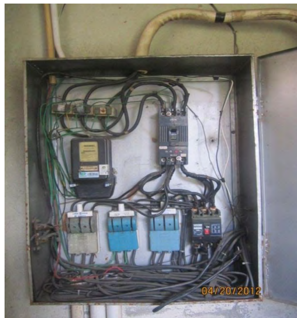
Figura 6.1. Tablero principal, subestación.
