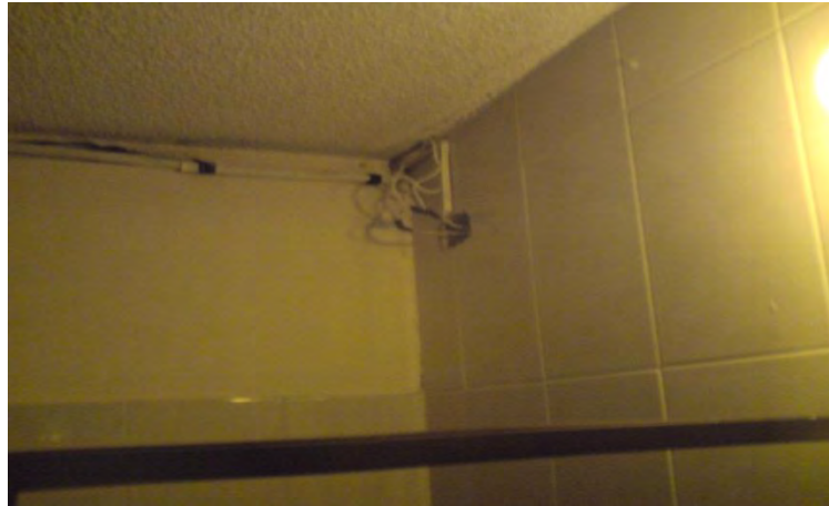
Figura 6.19. Conexión para ducha en el Crue.
