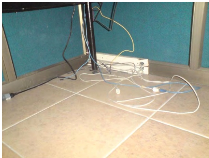
Figura 6.33. Canaleta sin tapa con cables expuestos.
