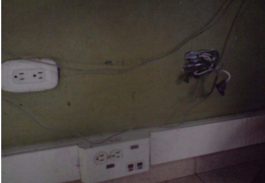
Figura 6.16. Tomas dañados en la oficina del Crue.
