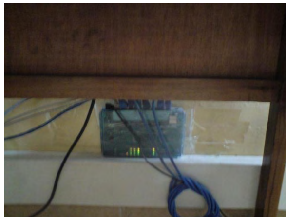
Figura 6.25. Switch pegado con cinta.
