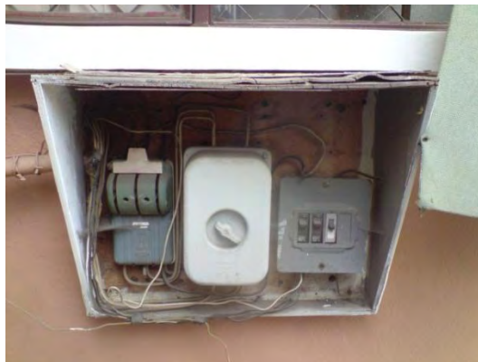
Figura 6.10. Tablero de distribución en el exterior del edificio.
