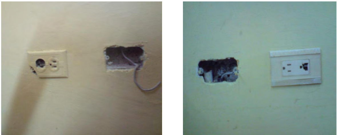
Figura 6.15. Tomas dañados en sindicato.
