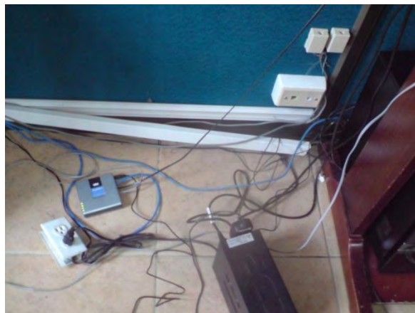
Figura 6.18. Cables eléctricos y de datos por el piso en el CRUE.
