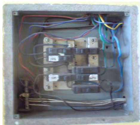
Figura 6.8 Tablero de distribución ubicado en el exterior de la oficina de población pobre y vulnerable.
