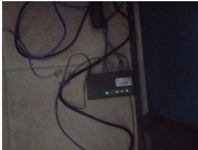
Figura 6.31. Switch mal instalado.
