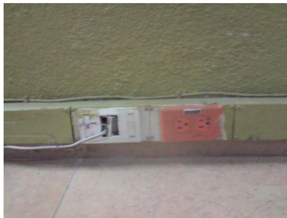
Figura 6.29. Toma de datos en mal estado.
