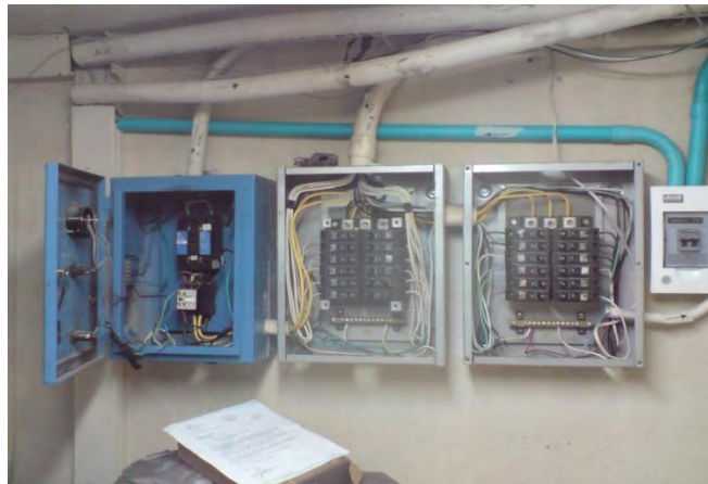
Figura 6.4. Tableros de distribución sin uso.
