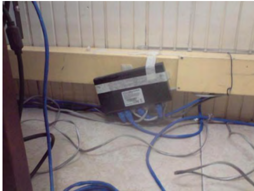
Figura 6.23. Switch pegado con cinta.
