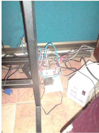
Figura 6.24. Cable fuera de la canaleta en el CRUE.
